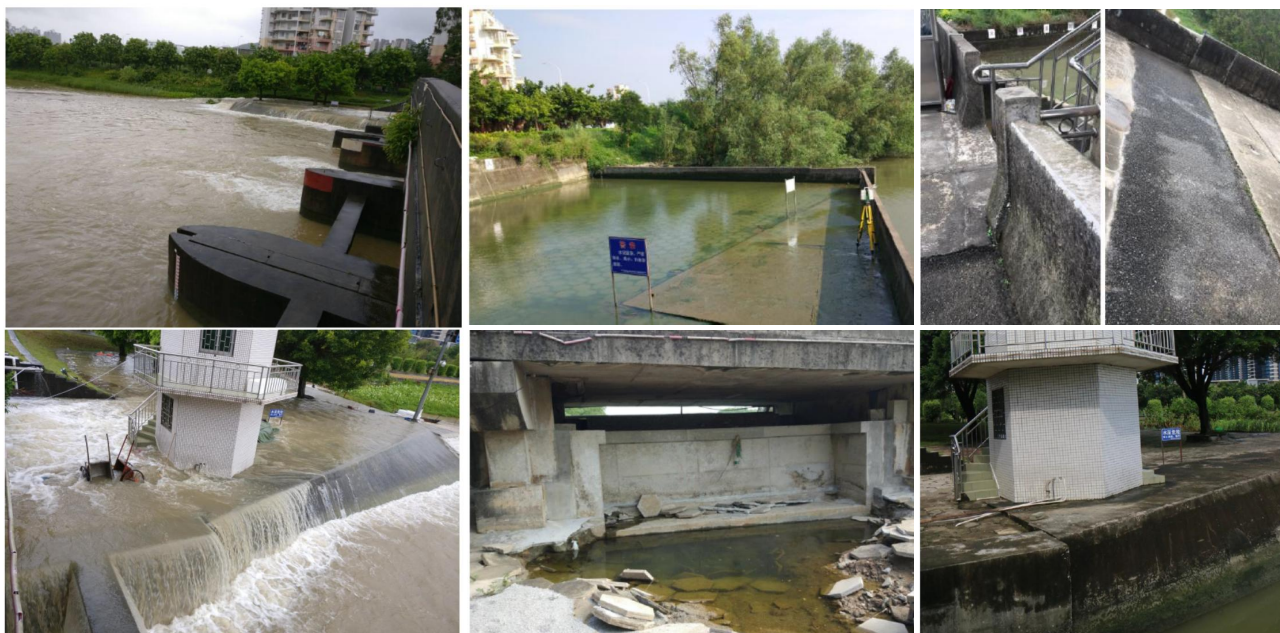
现状水闸现场问题点实拍图
